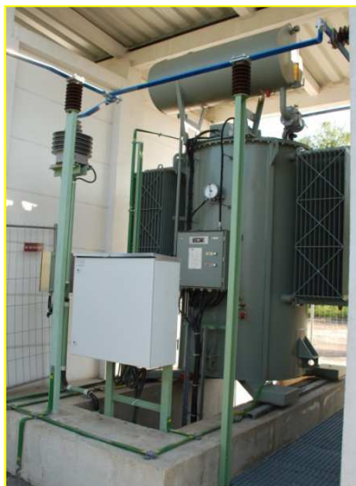
Obr. 3 Zhášecí tlumivka s 24-hodinovým provozem a maximálním kompenzačním proudem 550 A v síti 22 kV
