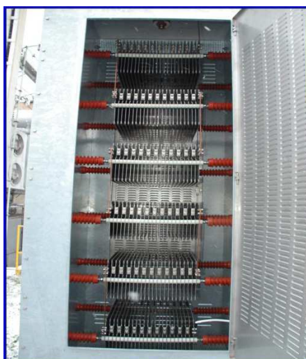
Obr. 2 Pohled do uzlového odporníku sítě 22 kV se jmenovitým proudem 1000 A
