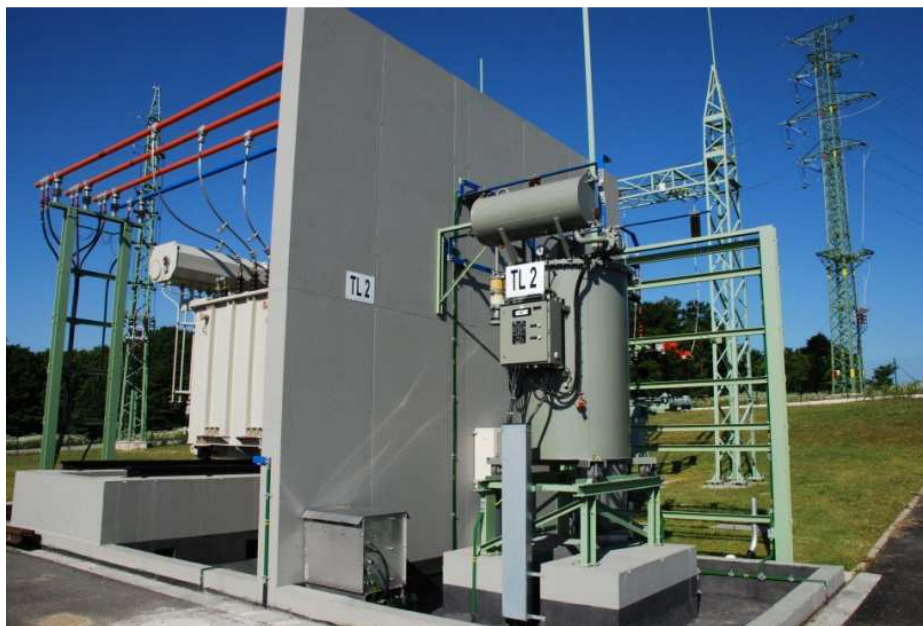
Obr. 4 Zhášecí tlumivka a napájecí transformátor 110 kV / 22 kV
