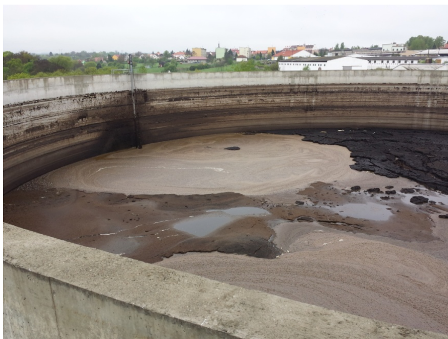
Obr.11: BPS sklad digestátu
