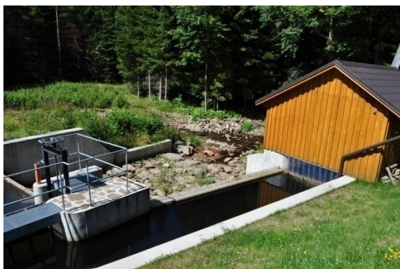
Obrázek 3-6: Jímací objekt na Úhlav
