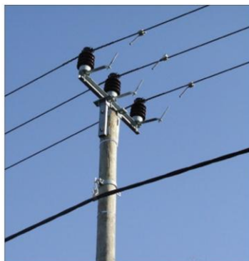
Obr. 3-1: Hrotové jiskřiště na venkovním vedení [4]
