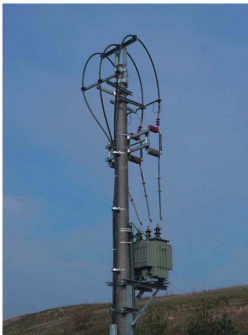
Obrázek 12.: Vyvedení výkonu – transformátor 22/0,4 kV
