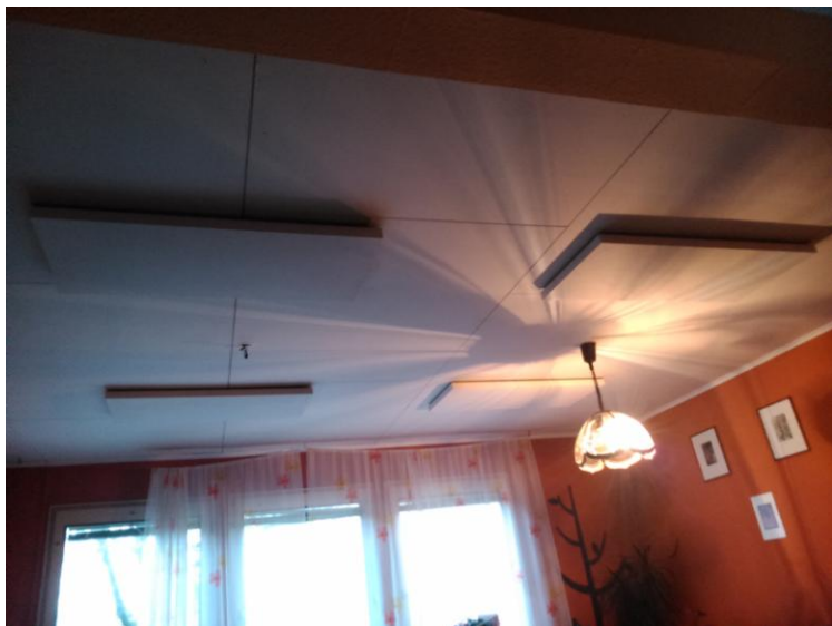
Obr. 20-5 Pohled na sálavé panely obývacího pokoje od dveří
