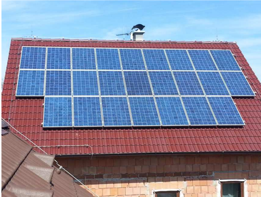
Obr. 6.1 Domácí FV elektrárna ve Lhotě
