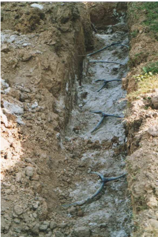
Obr. 6 – Napojení odvzdušňovacích ventilů. Zdroj: vlastní
