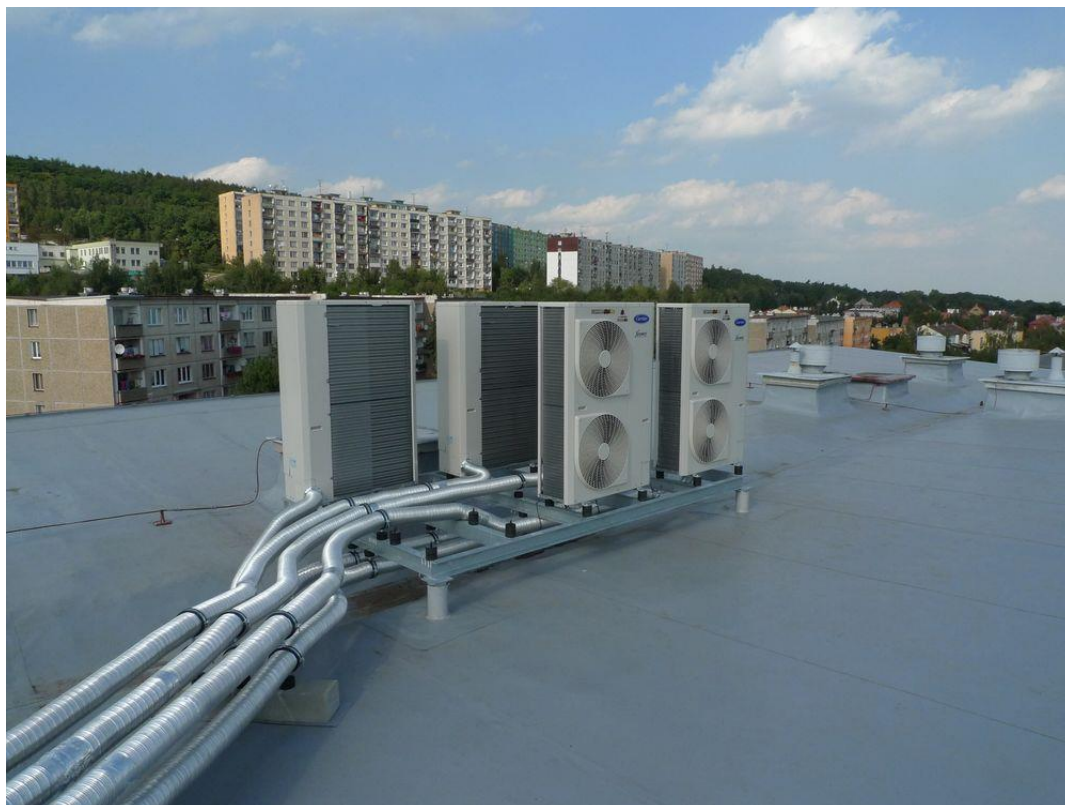
Obrázek 6: Tepelná čerpadla vzduch/voda zapojena kaskádně. Převzato z [11]
