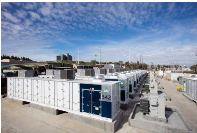
Obr. 17: Kalifornská akumulátorovna o výkonu 30MW a kapacitě 120MWh
