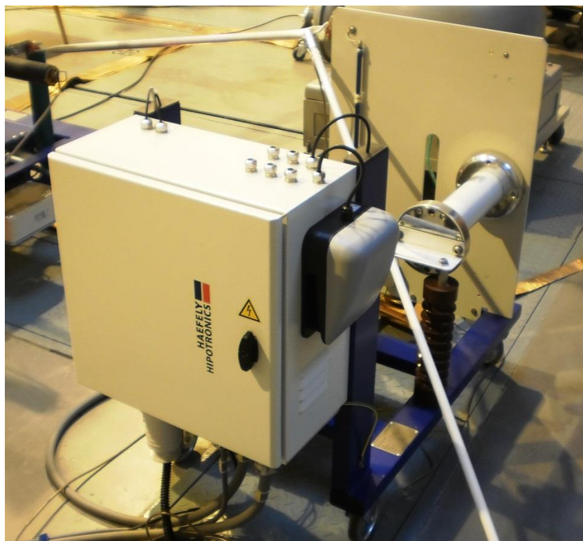
Obr. 7 Centrální řídicí jednotka a nabíjecí jednotka s transformátorem a usměřovačem
