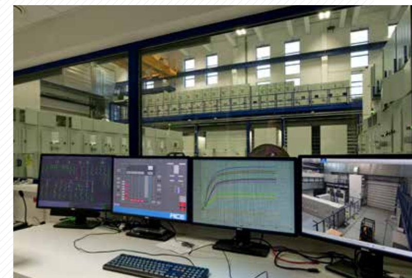
Halová laboratoř a zkušebna vysokonapěťové výkonové elektroniky a dopravní techniky v RICE.
