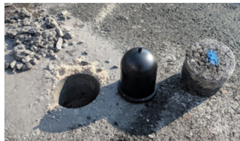
Jeden z parkovacích senzorů, nainstalovaných do povrchu parkoviště před budovou Fakulty elektrotechnické.
