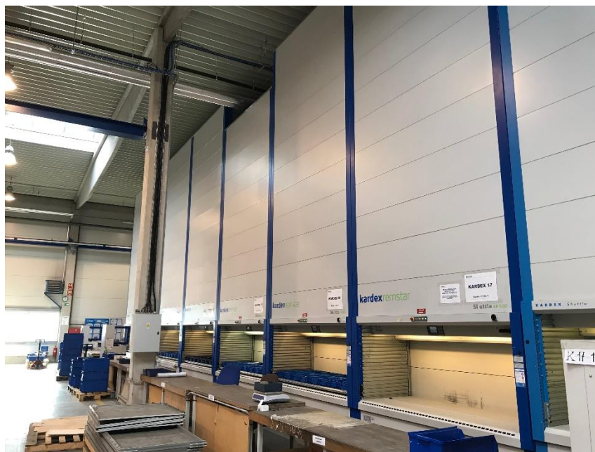
Obr. 33: Skladovací výtahový systém Kardex ve skladu Škoda Transportation [31]
