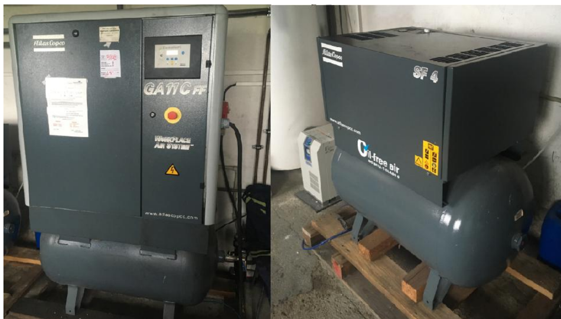
Obr. 29: Kompresor Atlas Copco + sušička vzduchu
