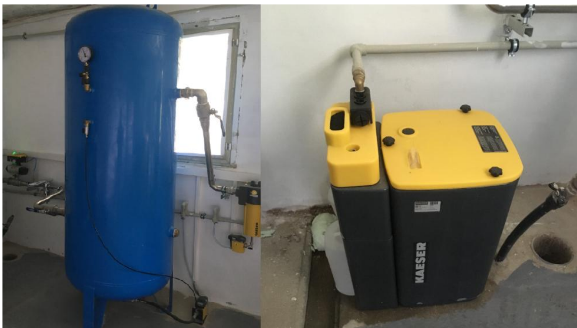
Obr. 31: Zásobník stlačeného vzduchu a odlučovač vody
