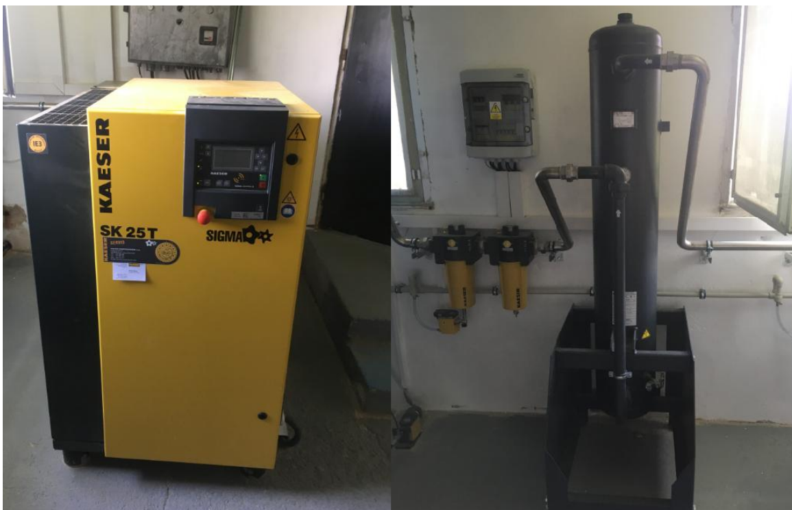
Obr. 30: Kompresor Kaeser a filtry
