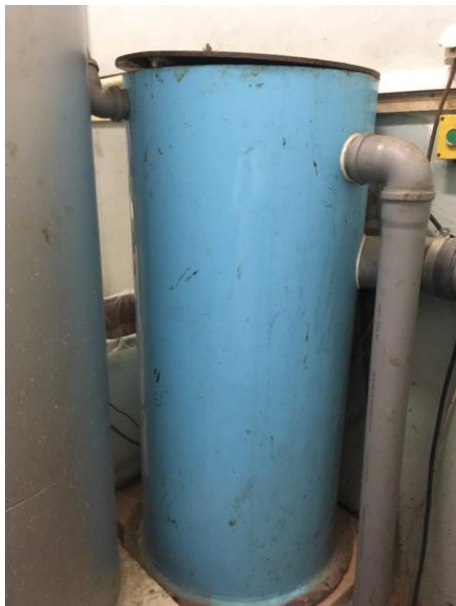
Obrázek 9 – Čerpací jímka vyčištěné vody
