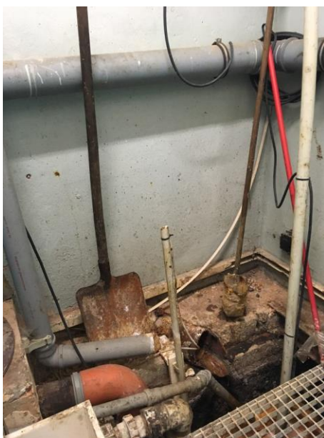
Obrázek 2 – Přítok odpadní vody z provozu kuchyně
