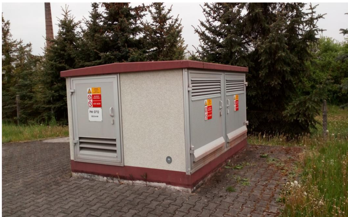
Obrázek 4: Trafostanice u areálu firmy BRUDER CZ s.r.o.
