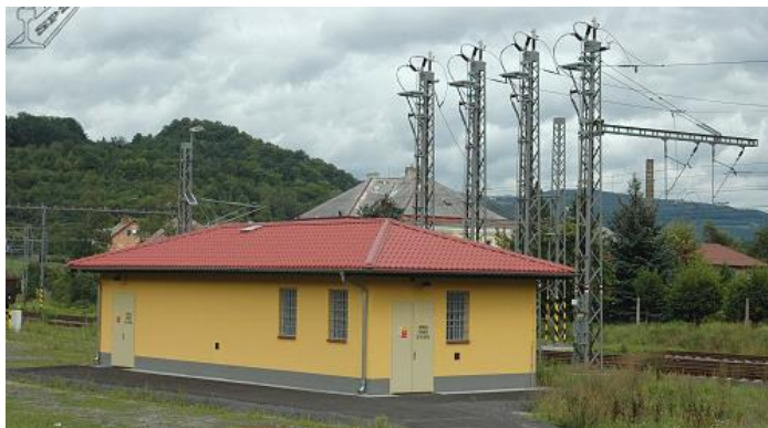
Obr. 2-12 Spínací stanice 25 kV Vojkovice převzato z [6]
