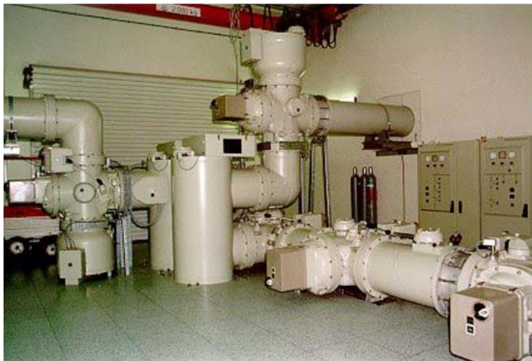
Obr. 2-4 Zapouzdřená rozvodna Svitavy od ABB převzato z[9]
