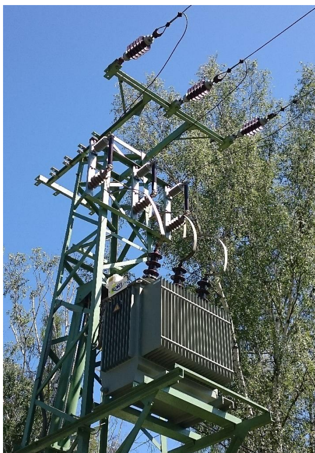
Obr. 8: Pohled na distribuční transformátor zřepedu [autor]
