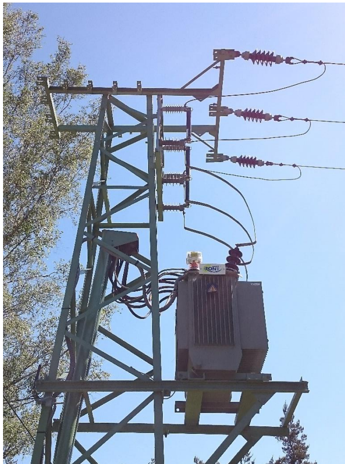
Obr. 9: Pohled na transformátor z boku [autor]
