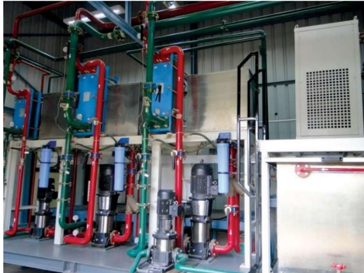
Obr. 2.5.2 Chladicí systém včetně čerpadel [26]
