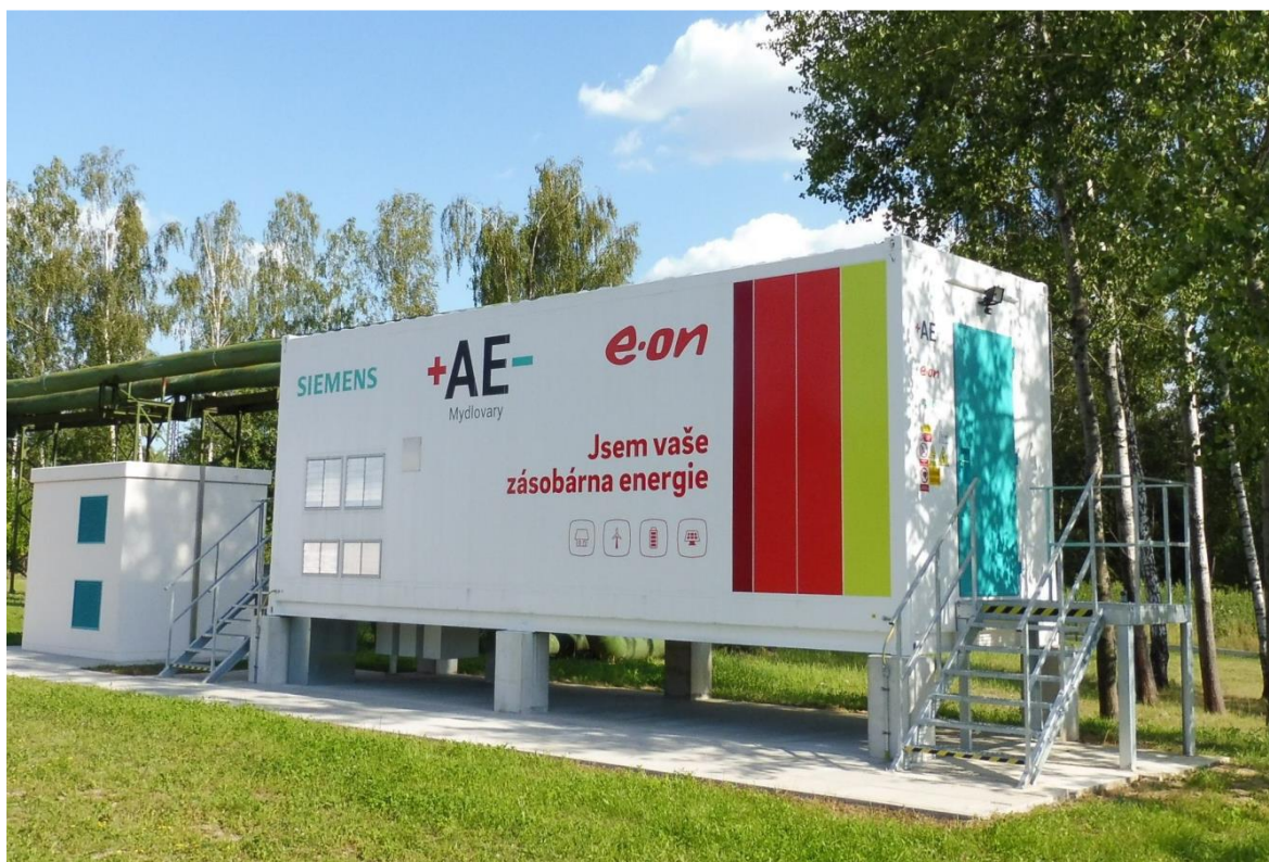
Obrázek 6: Bateriové úložiště Mydlovary
