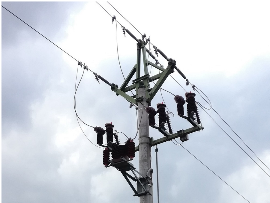
Obr. A.4: Dálkově ovládaný úsečník se zhášecí komorou a měřením U, I (na vedení typu pařát)
