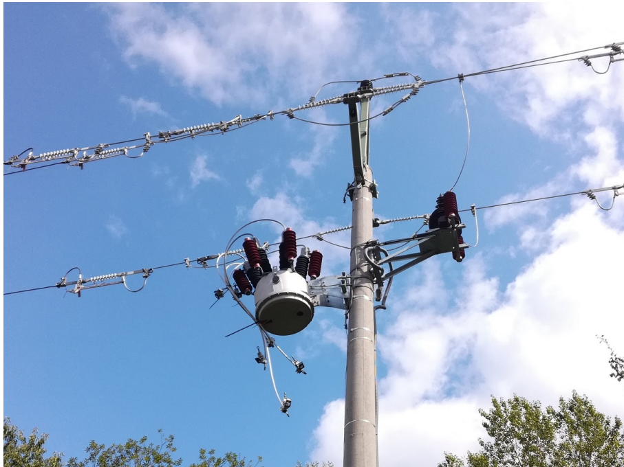
Obr. A.6: Odpojený recloser
