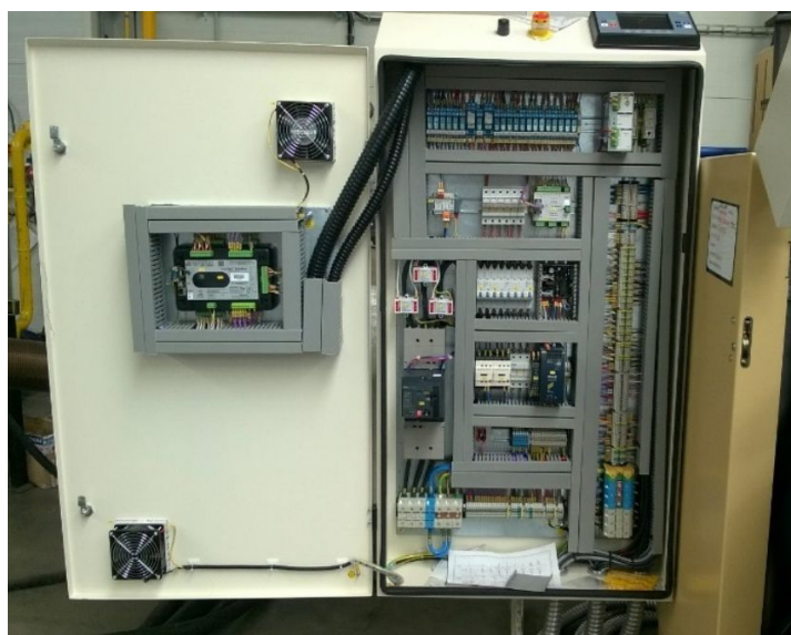
Obrázek 14: Foto rozvaděče mikrokogenerační jednotky
