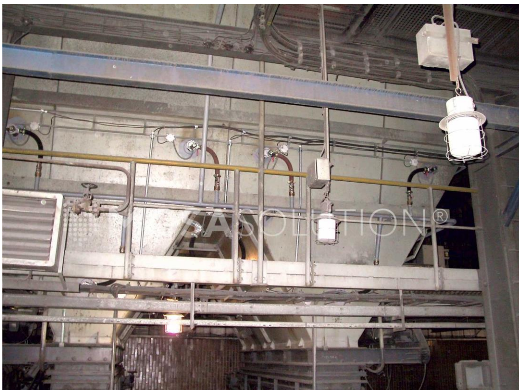
Obr. 8 – 3 Zásobník kotle K3 s instalovanými tryskami Myrlen VA - 51 [14]
