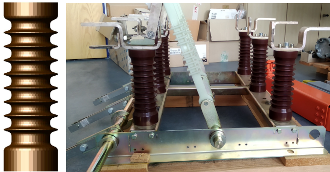
Obr. 2: Podpěrné izolátory na odpojovači
