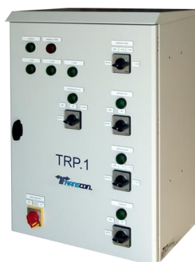
Obr. 4.5 Ovládací panel rozváděče [17]
