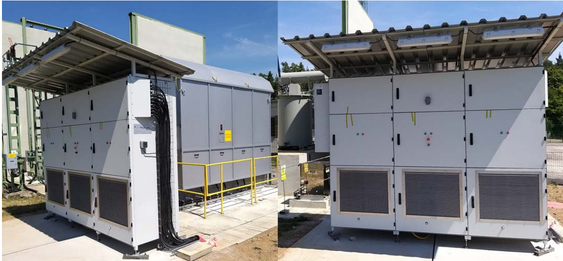
Obr. 67 - Pilotní provoz na rozvodně Kralovice
