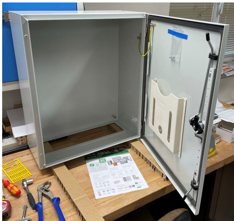
Obrázek 4.5 Rozvaděčová skříň [archiv autora]
