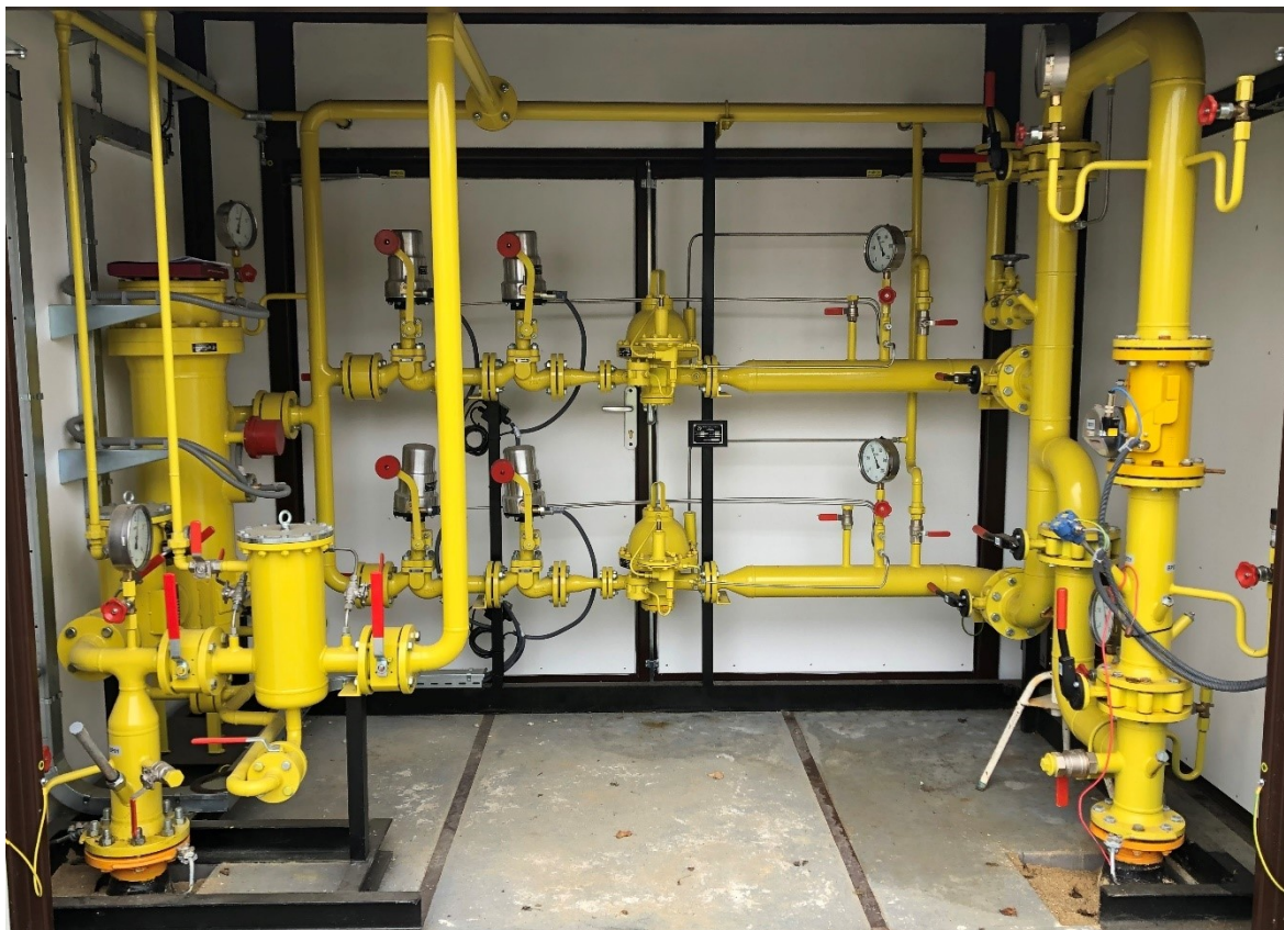
Obrázek 2.3 Pohled na místnost technologie [archiv autora]
