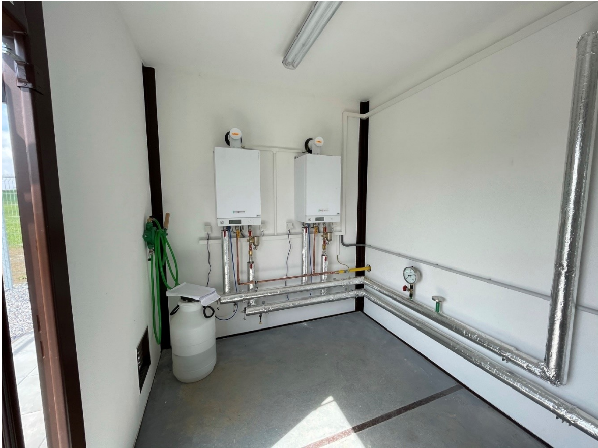
Obrázek 5.2 Pohled na místnost kotelny RS [archiv autora]
