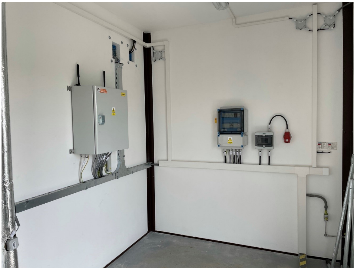
Obrázek 5.4 Rozvaděč na zdi v místnosti kotelny [archiv autora]
