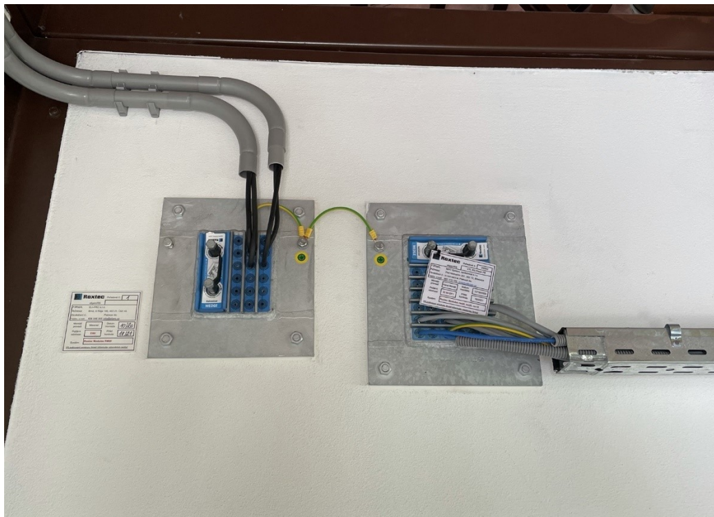
Obrázek 5.5 Plynotěsný průstup mezi technologií a kotelnou ROXTEC [archiv autora]
