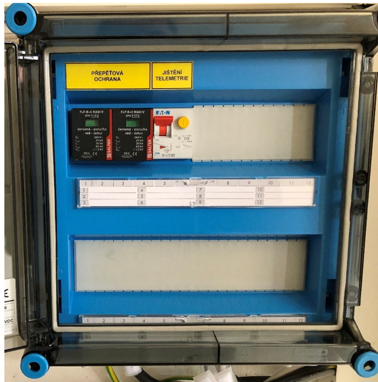
Obrázek 5.9 Rozvaděč s přepětovou ochranou [archiv autora]
