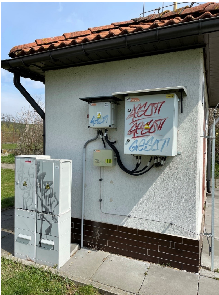
Obrázek 2.8 Venkovní instalace na RS [archiv autora]
