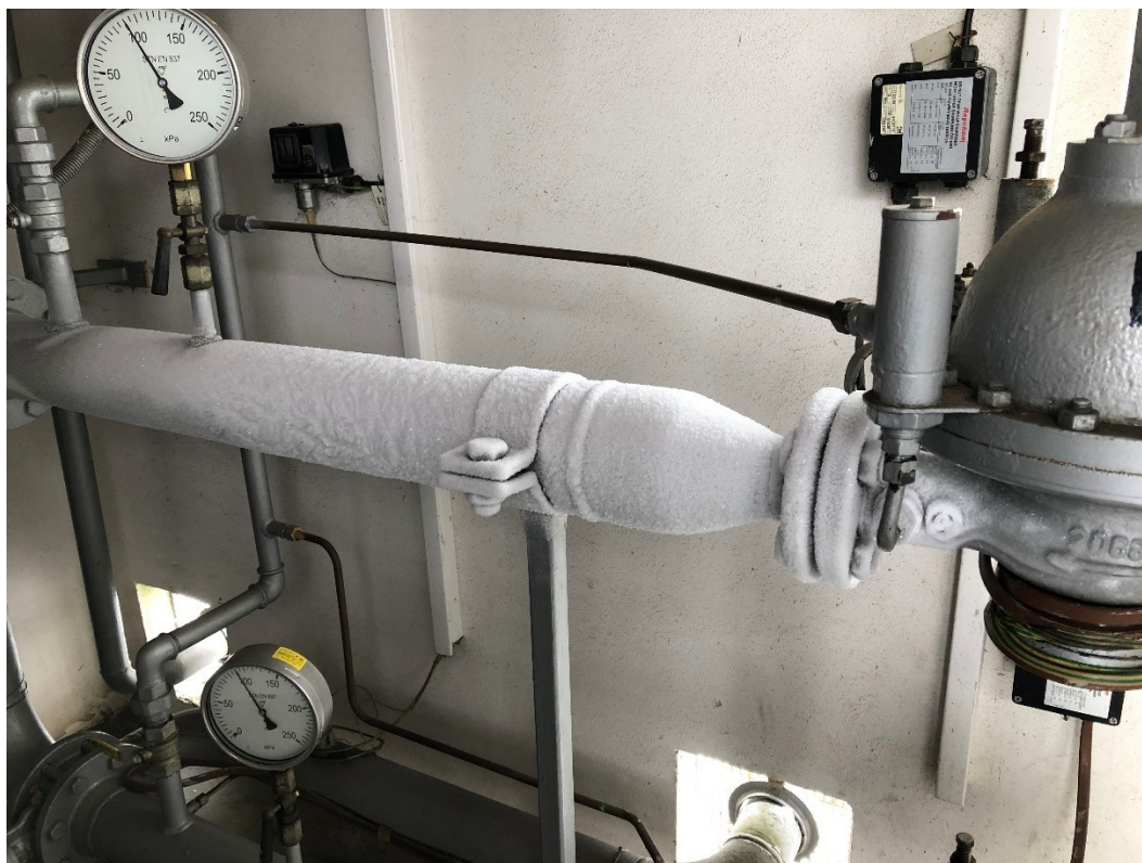
Obrázek 2.6 Omrzlé potrubí, topný kabel na regulátoru [archiv autora]
