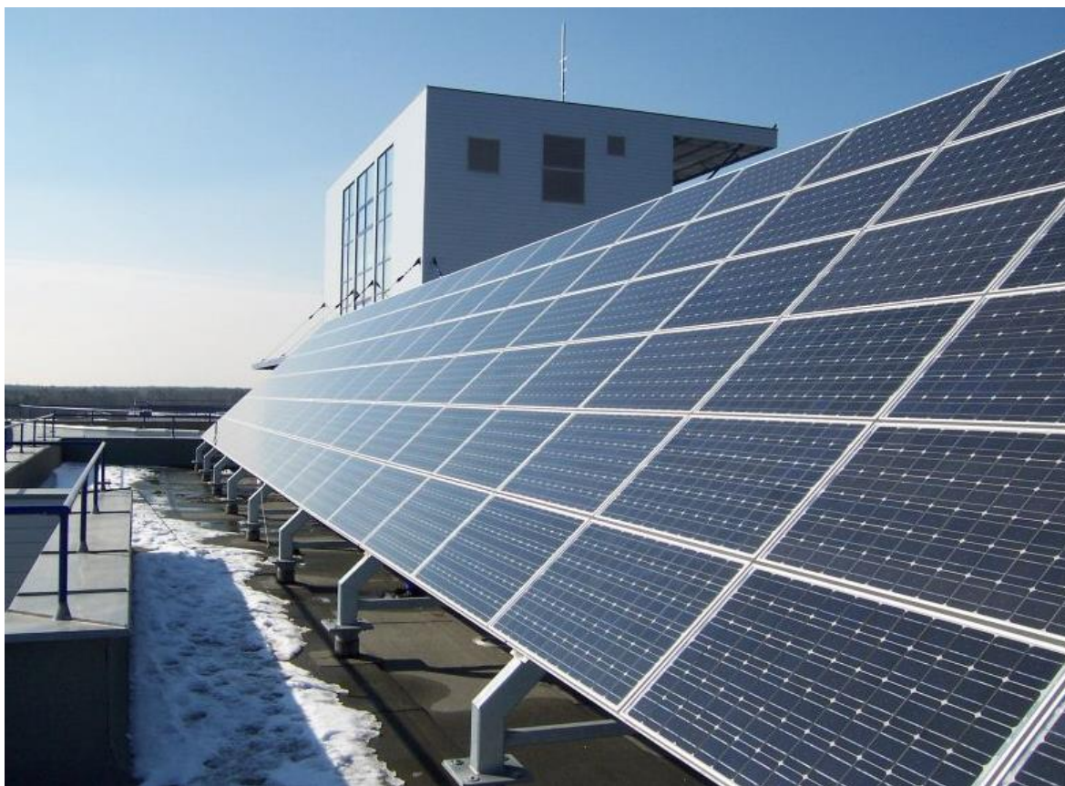
Obr. 1.3 Monokrystalické panely na střeše FEL ZČU [25]
