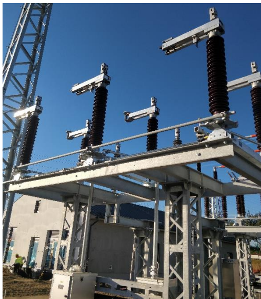
Obr. 3.5 – Odpojovače S2DAT ve vypnutém stavu
