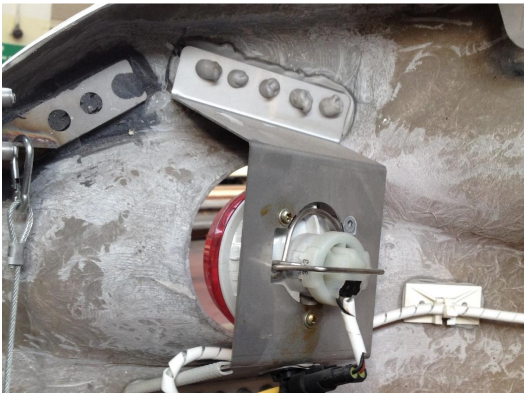
Obrázek 88: Nakupovaný lepený díl s neznámým lepeným spojem (šedé adhesivum), který je v rozporu s technickým zadáním a tak potenciálním rizikem.
