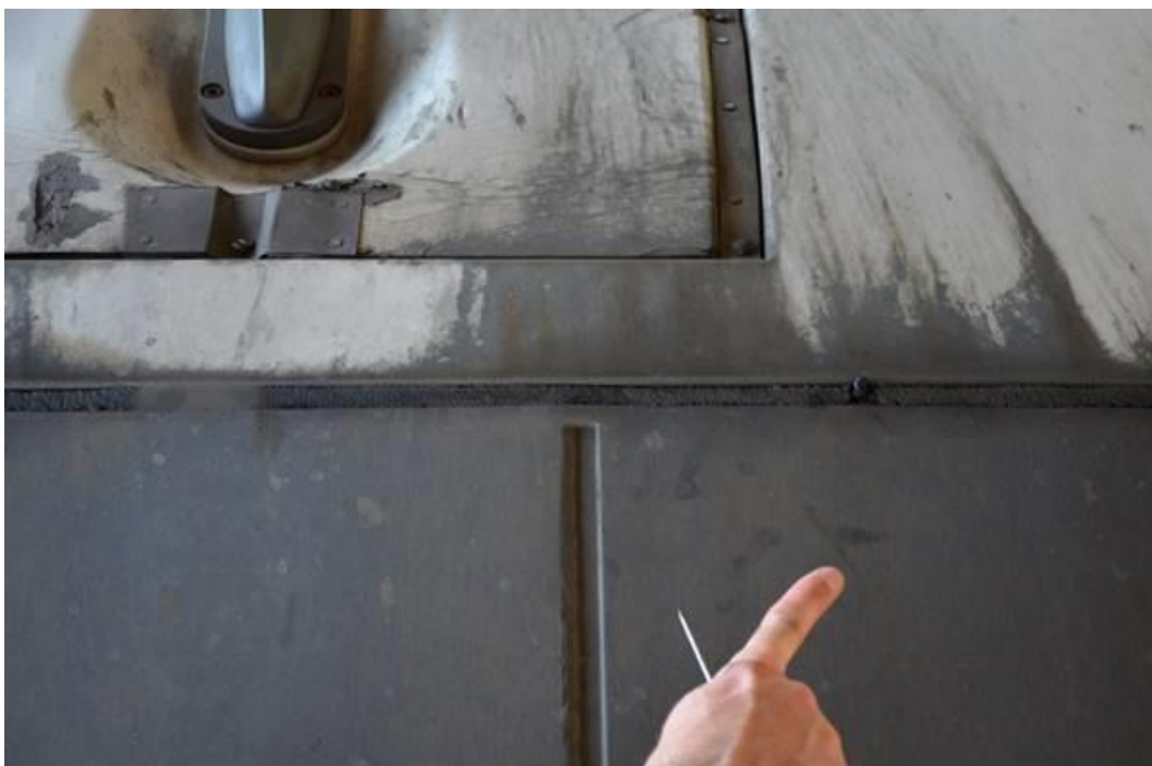
Obrázek 95: Degradace tmeleného spoje zapříčiněná použitím nevhodného adhesiva (tmelu) s nedostatečnou chemickou a fyzikální odolností.
