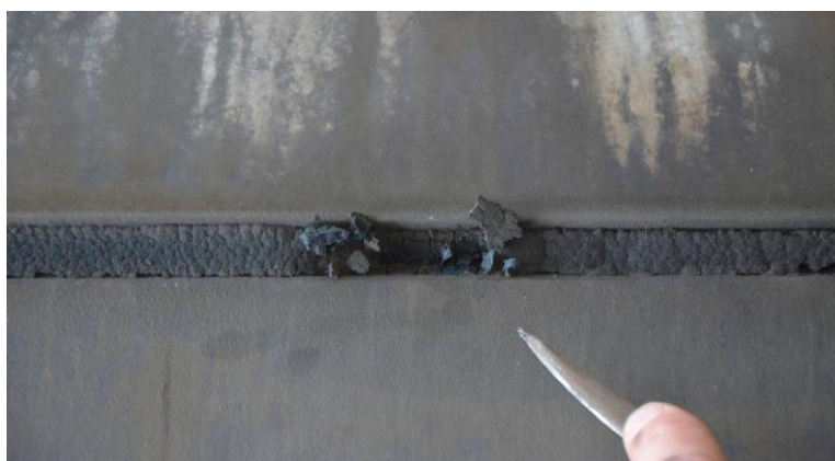
Obrázek 83: Příklad degradace tmeleného spoje s 1k PUR adhesivem. [51]
