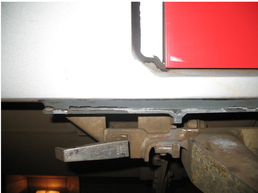
Obrázek 86: Selhání lepeného spoje způsobené nevhodným konstrukčním návrhem spoje z hlediska dimenzování vzhledem k jeho přípustné zatížitelnosti a provoznímu namáhání.
