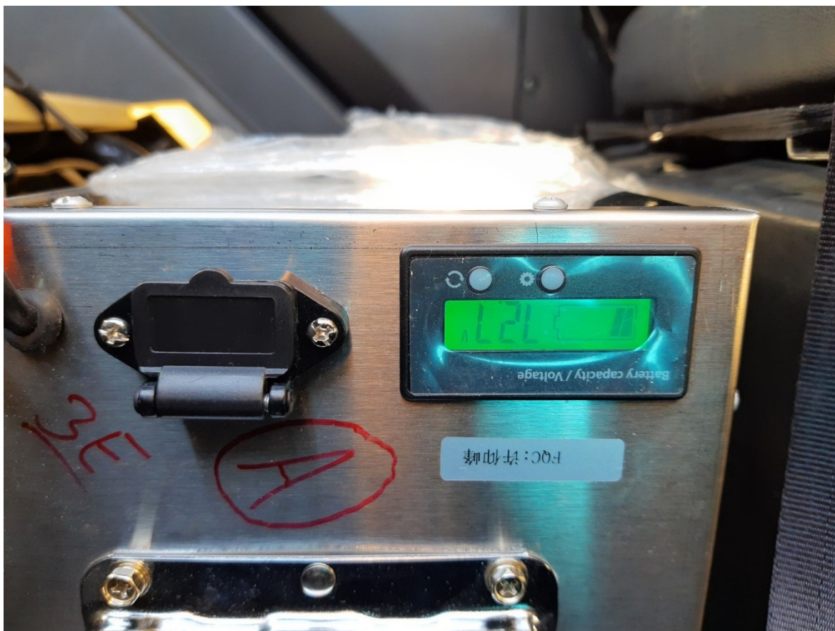
Obr. 25 Boční pohled na box bateriového systému
