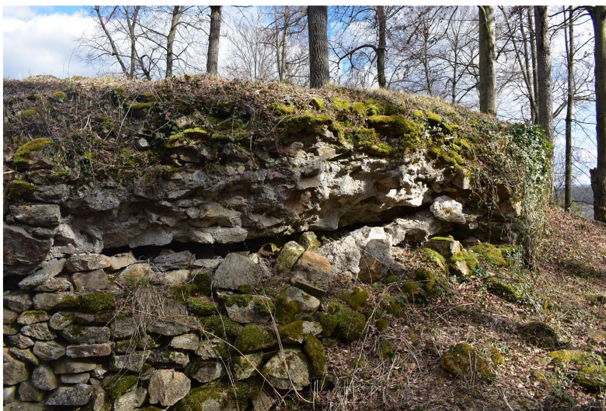
Obr. 22. Hrad Osule. Detailní záběr na vylámané zdivo severního bergfritu (rok 2019). Foto autor.
