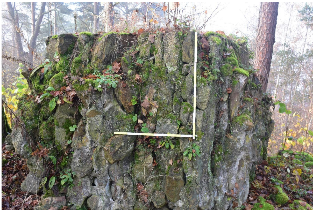
Obr. 30. Hrad Osule. Pohled na odtržený kus zdiva z čelního palácového křídla se zbytky špalety okna na západní straně (rok 2020). Foto autor.
