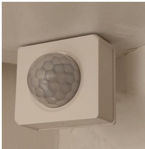
Obr. 12 Nainstalovaný senzor pohybu
