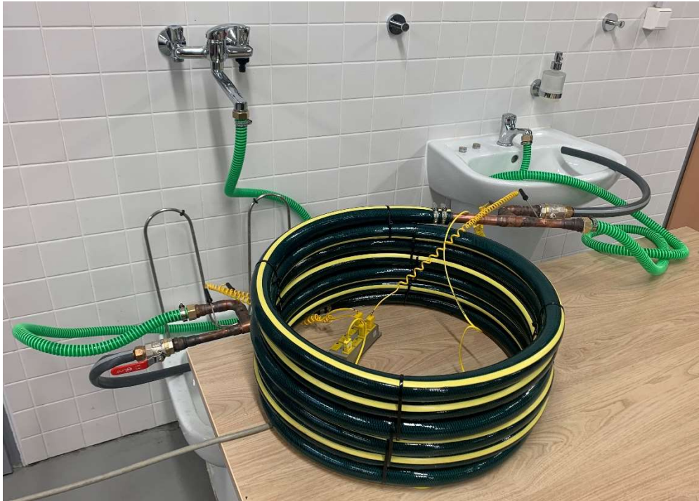
Obr. 22: Výměník před měřením
