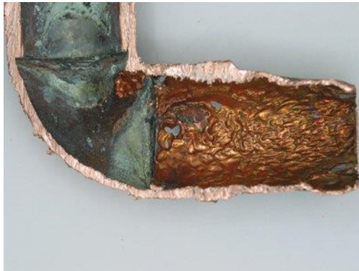
Obr. 2. Trubka poškozená erozí [7].
