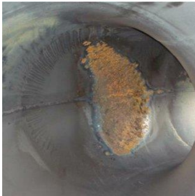
Obr. 1. Koroze v potrubí [6].
