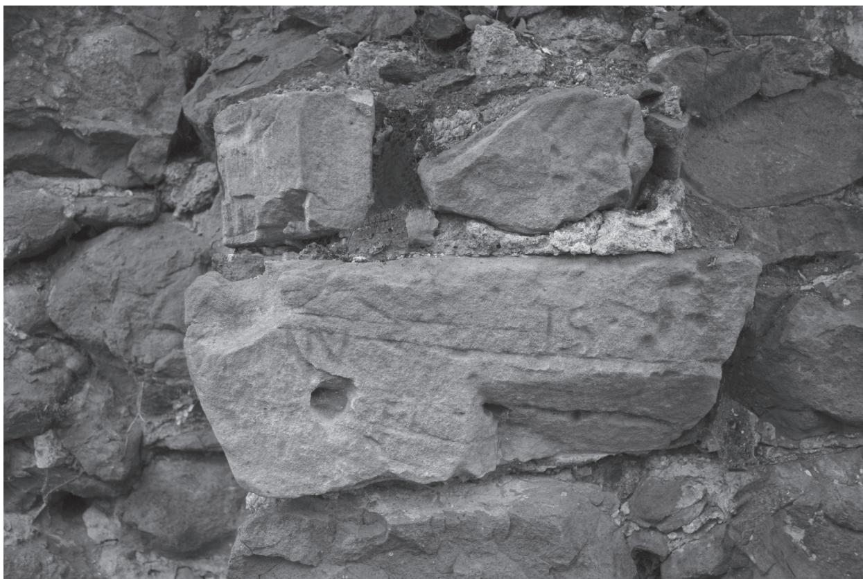
Obr. 8. Architektonický článek, zazděný do armování nároží interiéru domnělé kaple na svahové kupě nad Levínem (okr. Litoměřice). Foto F. Gabriel. – Abb. 8. Eingemauerter Bauteil in der Armierung der Ecke des Interieurs der vorgeblichen Kapelle. Fotografie F. Gabriel.
