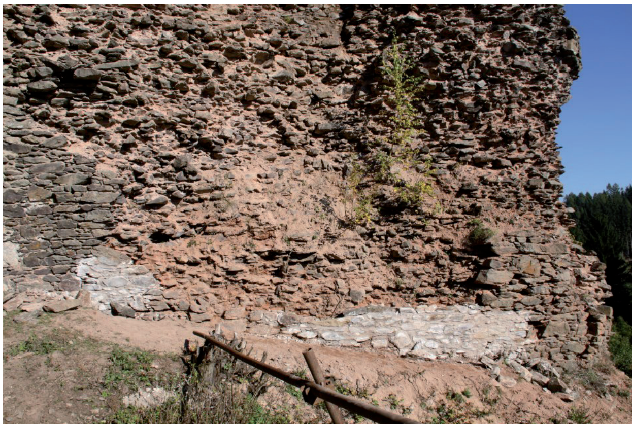
Obr. 13. Počáteční fáze konzervace zdiva jihozápadního nároží hradu. Foto M. Kahoun mladší 2012. – Abb. 13. Die Anfangsphase der Konservierung des Mauerwerkes der südwestlichen Ecke der Burg. Fotografie, M. Kahoun der Jüngere 2012.
