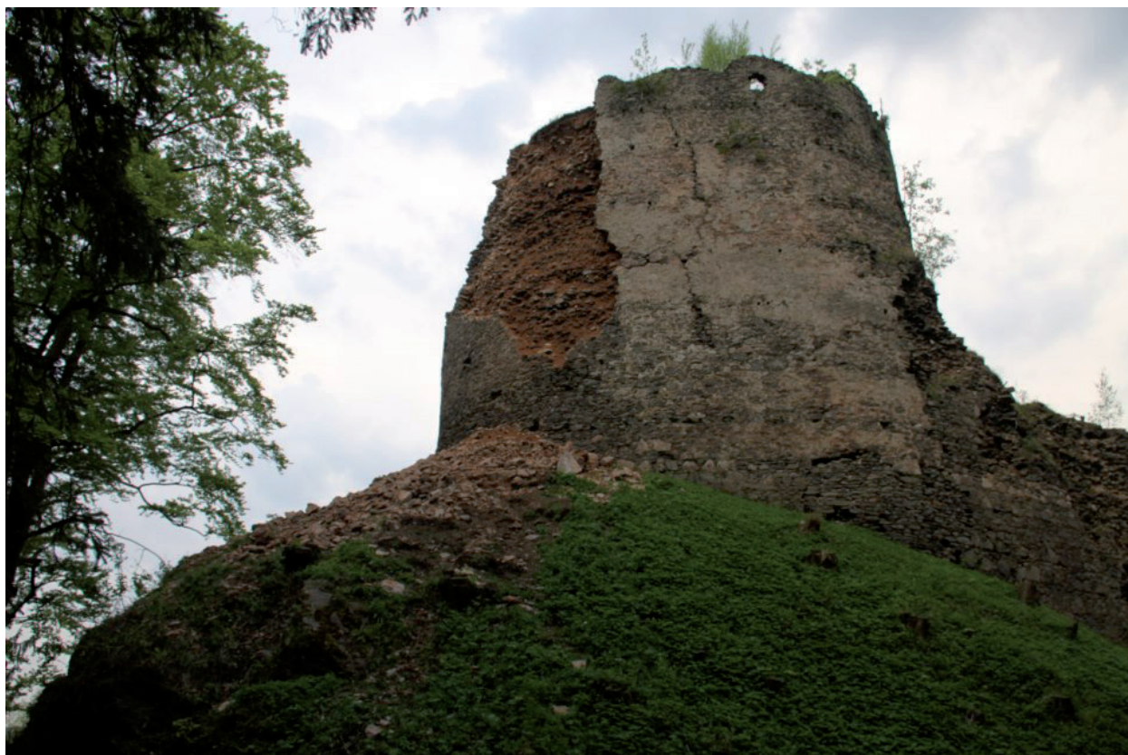
Obr. 14. Poškození věže po zřícení části lícového zdiva na severovýchodní straně v roce 2013. Foto M. Kahoun mladší 2013. – Abb. 14. Beschädigung des Turmes nach dem Absturz eines Teils des äußeren Mauerwerkes auf der nordöstlichen Seite im Jahre 2013, Fotografie M. Kahoun der Jüngere 2013.
