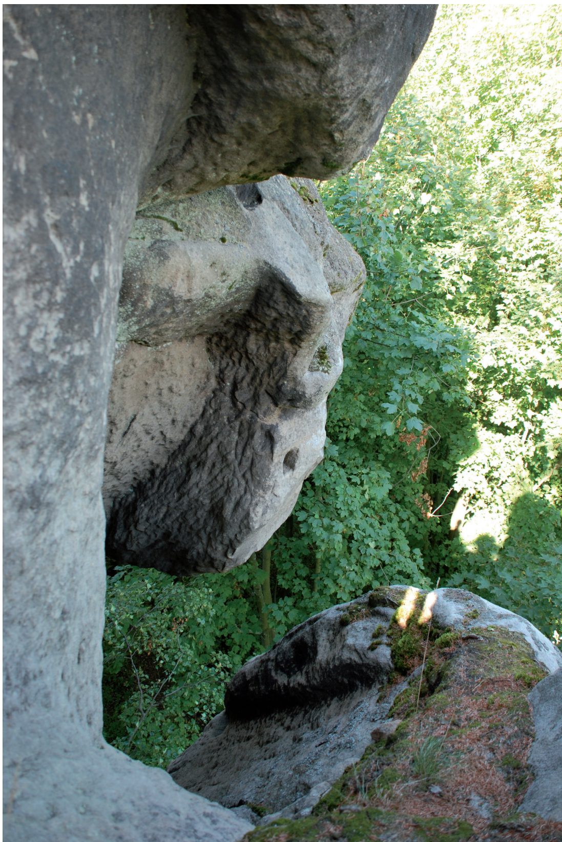
Obr. 20. Hrad Skály (Bischofstein). Do skály vysekaná horní partie podkladu pro šikmé schodiště v chodbě, otevřené k severu a zpřístupňující suk B po severní stěně. Foto L. Kursová. – Abb. 20. Burg Skály (Bischofstein). In den Fels geschlagener oberer Teil der Auflage für die schiefe Treppe im Gang. Der Gang ist nach Norden geöffnet und macht Fels B über die Nordwand zugänglich. Foto L. Kursová.
