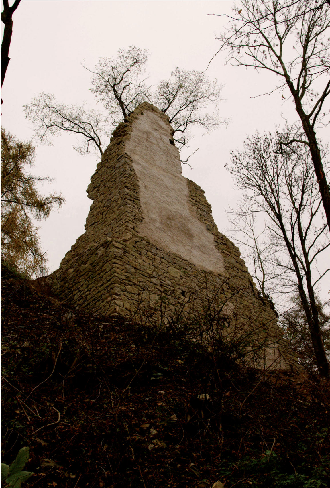
Obr. 6. Brandýs nad Orlicí. Stabilizované torzo tzv. věže s imitací historické omítky. Autor M. Kudrnovský. – Abb. 6. Brandýs nad Orlicí. Stabilisierter Torso des sogenannten Turms mit Imitation des historischen Putzes. Autor M. Kudrnovský.
