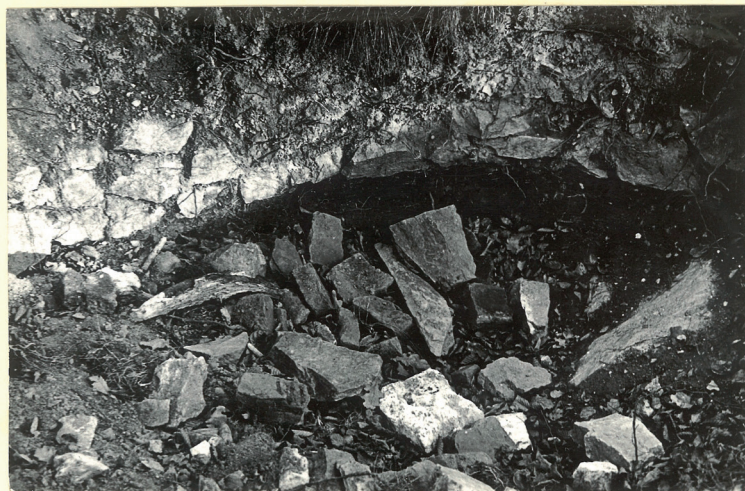
Úsek 29 - Zatáčející se zeď, stojící na půdě, nezapuštěná do skály.
