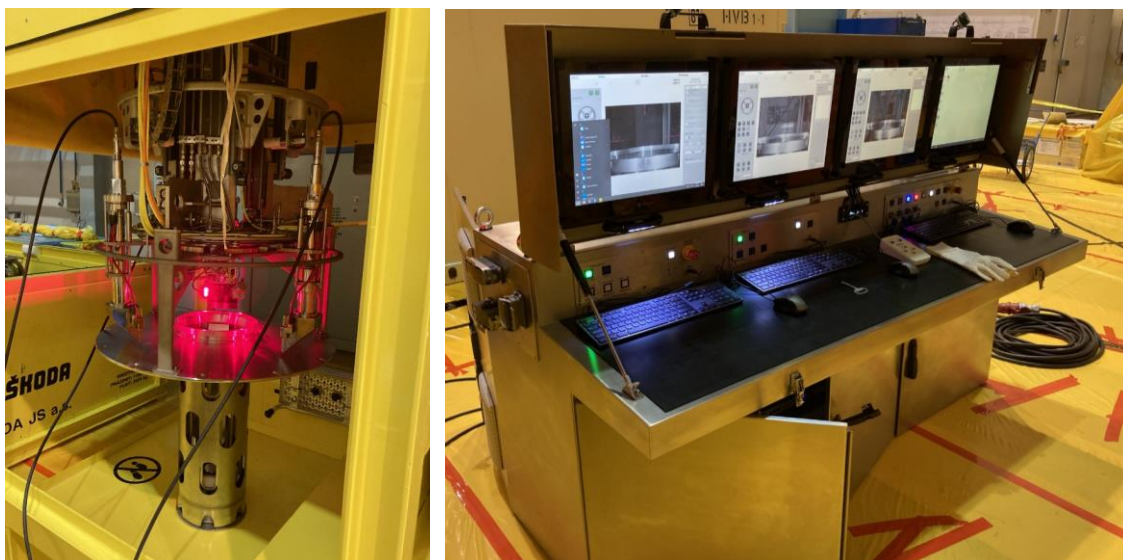
Obr. 9: Kontrola funkce TV kamer během uskladnění v BAPP
