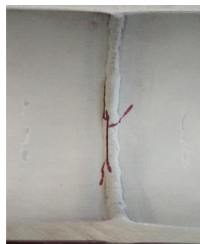
Obr. 5: Síť trhlin vedoucích od vrubu ve svaru až do teplem ovlivněné oblasti
