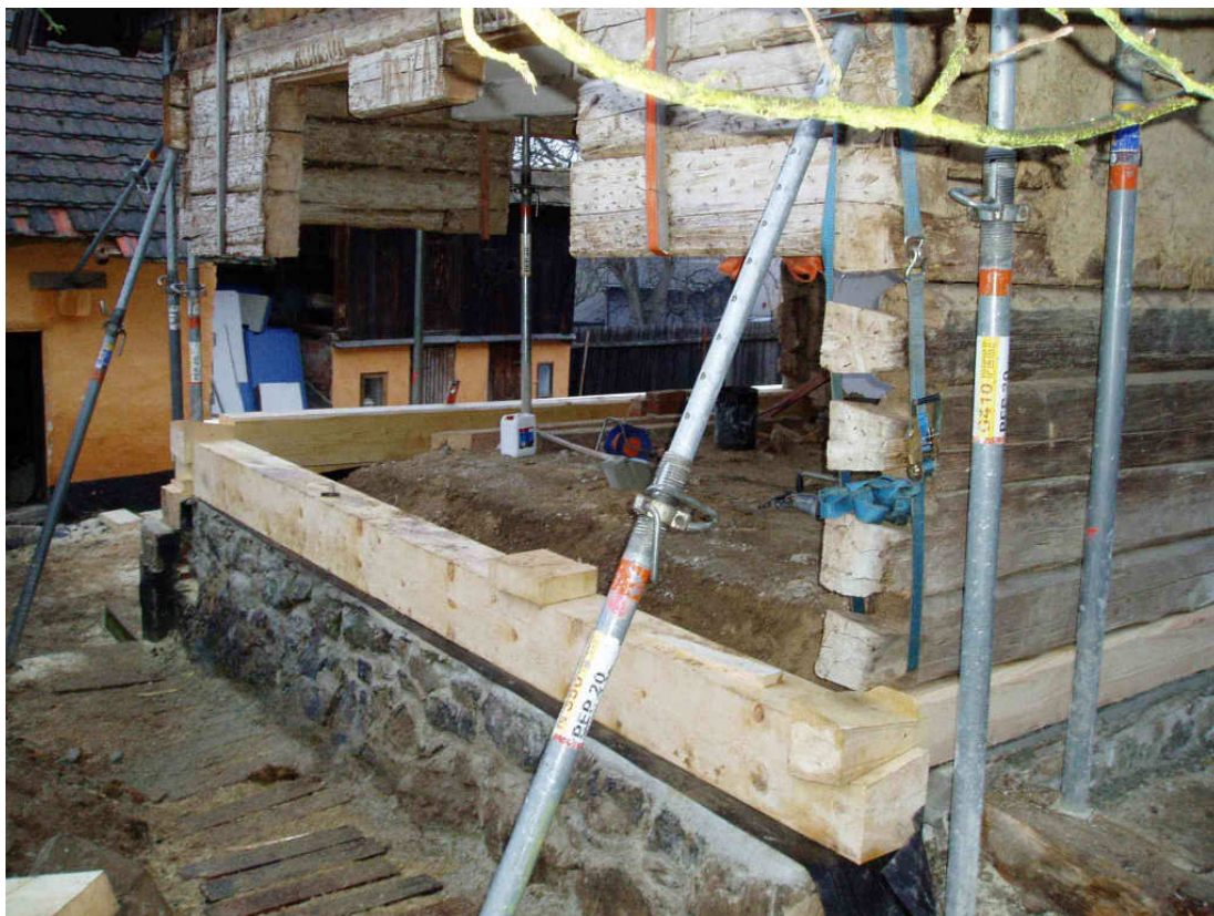
Obrázek 8: Montáž prvního trámu štítové stěny na nově vyzděnou podezdívku. Zdroj: archiv autora.
