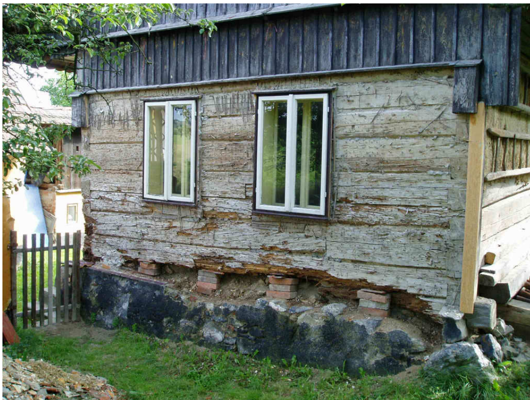
Obrázek 4: Stav roubení štítové stěny po sejmutí novodobé omítky. Zdroj: archiv autora.
