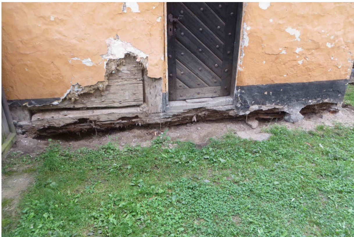
Obrázek 20: Stav prahového trámu špýcharu před opravou. Zdroj: archiv autora.
