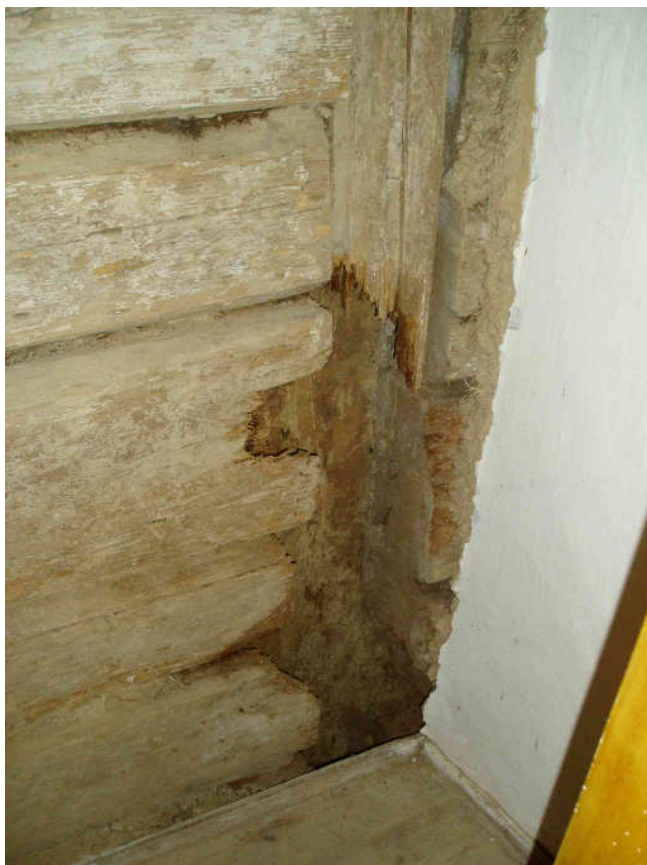
Obrázek 2: Stav rohu poškozeného mravencem dřevokazem po očištění.
