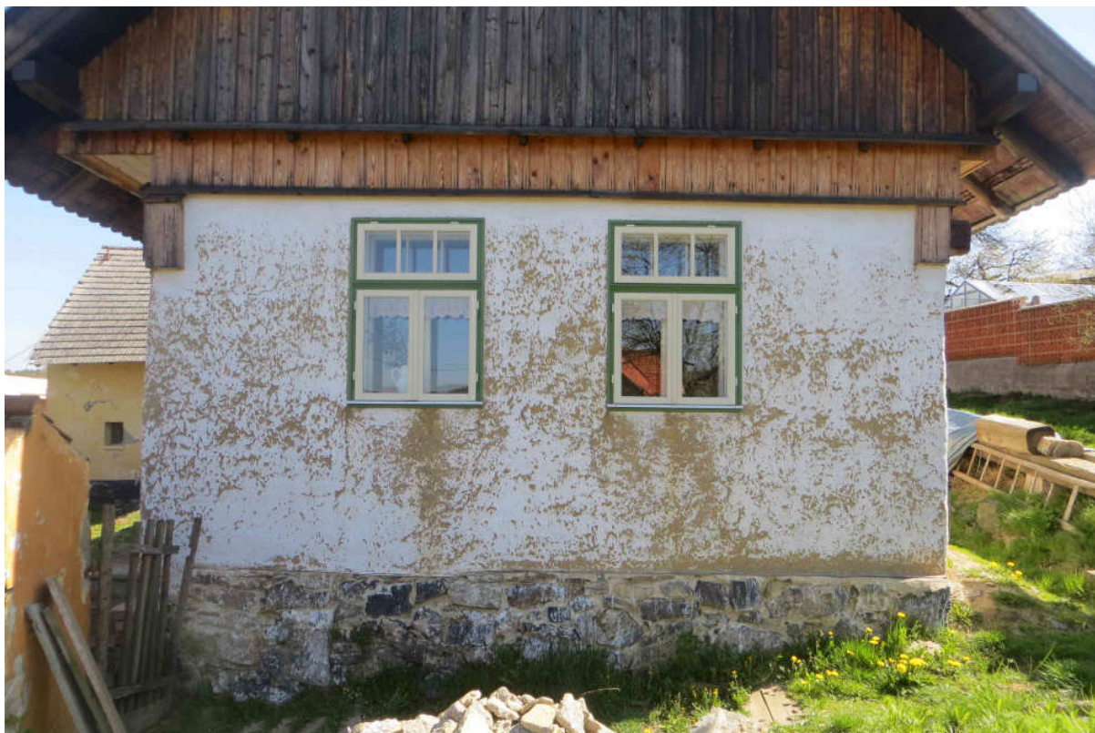
Obrázek 18: Kožich na štítové stěně poškozený deštěm.
