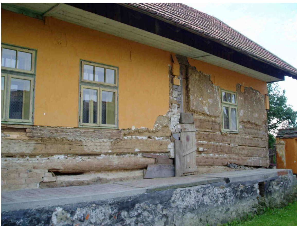
Obrázek 3: Stav roubení stěny do dvora po sejmutí novodobých omítek.
