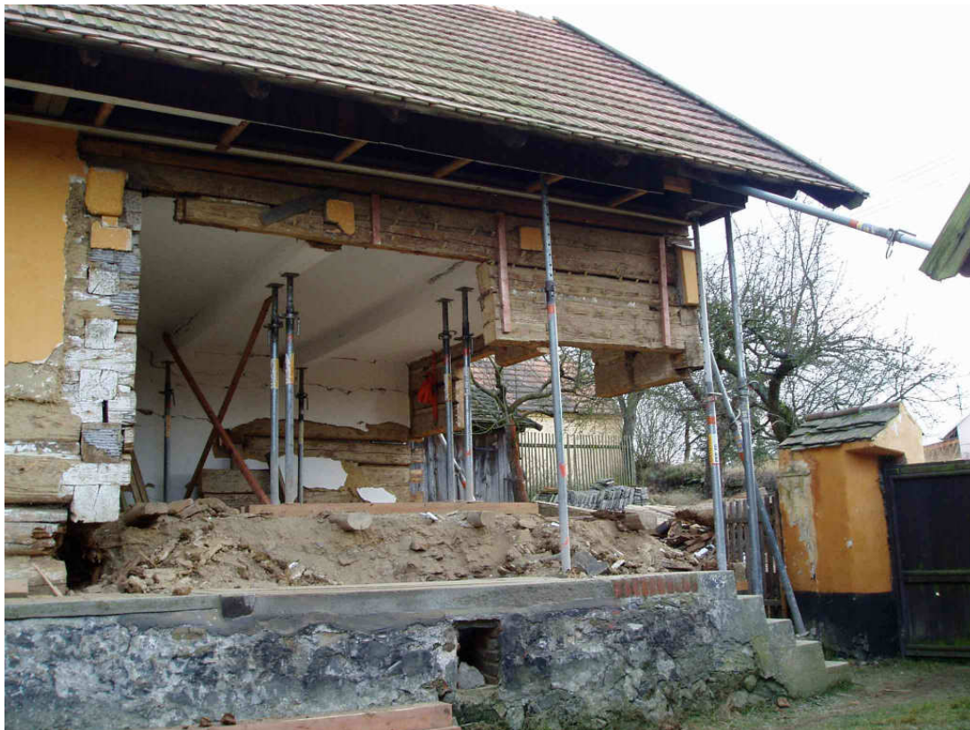
Obrázek 5: Stav roubení stěny do dvora po odstranění poškozeného roubení. Zdroj: archiv autora.
