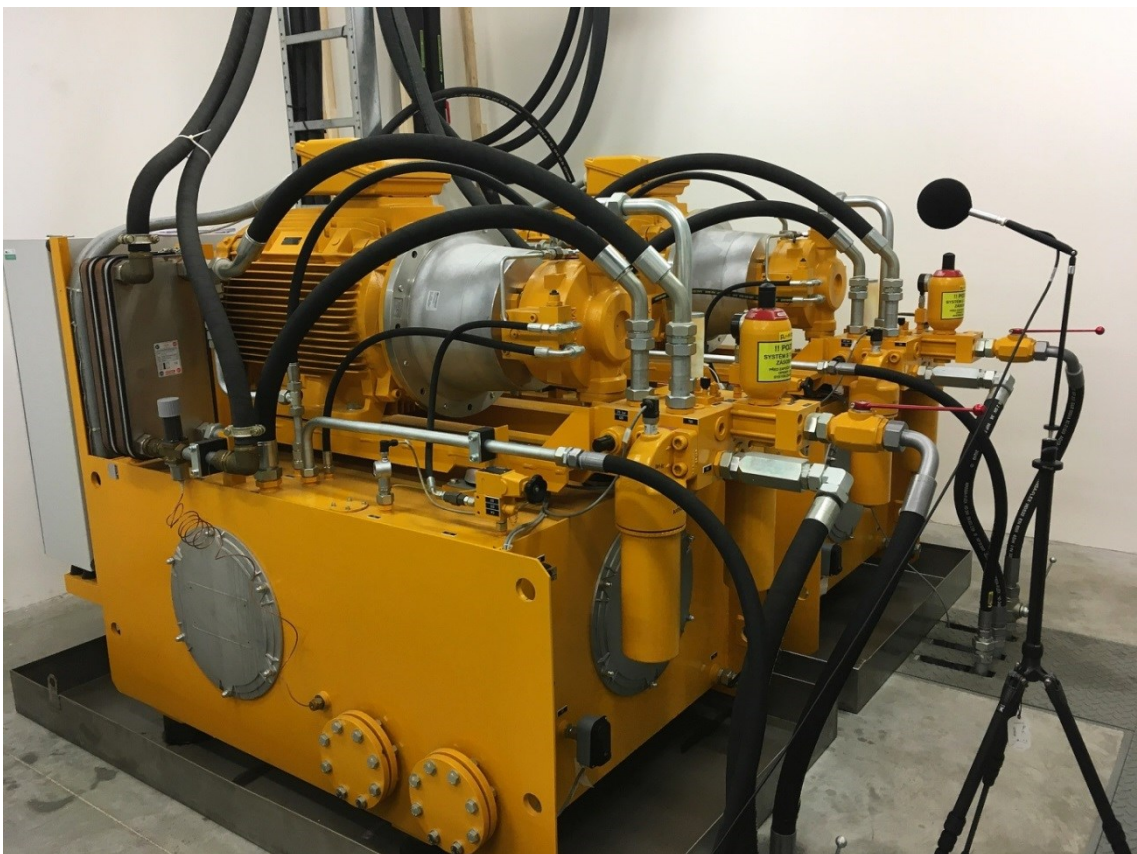
Obrázek 4-22 - Detailní pohled na čerpadla umístěná v místnosti
