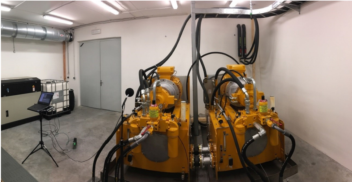
Obrázek 4-21 - Testovaná místnosti olejového hospodářství s čerpadly
