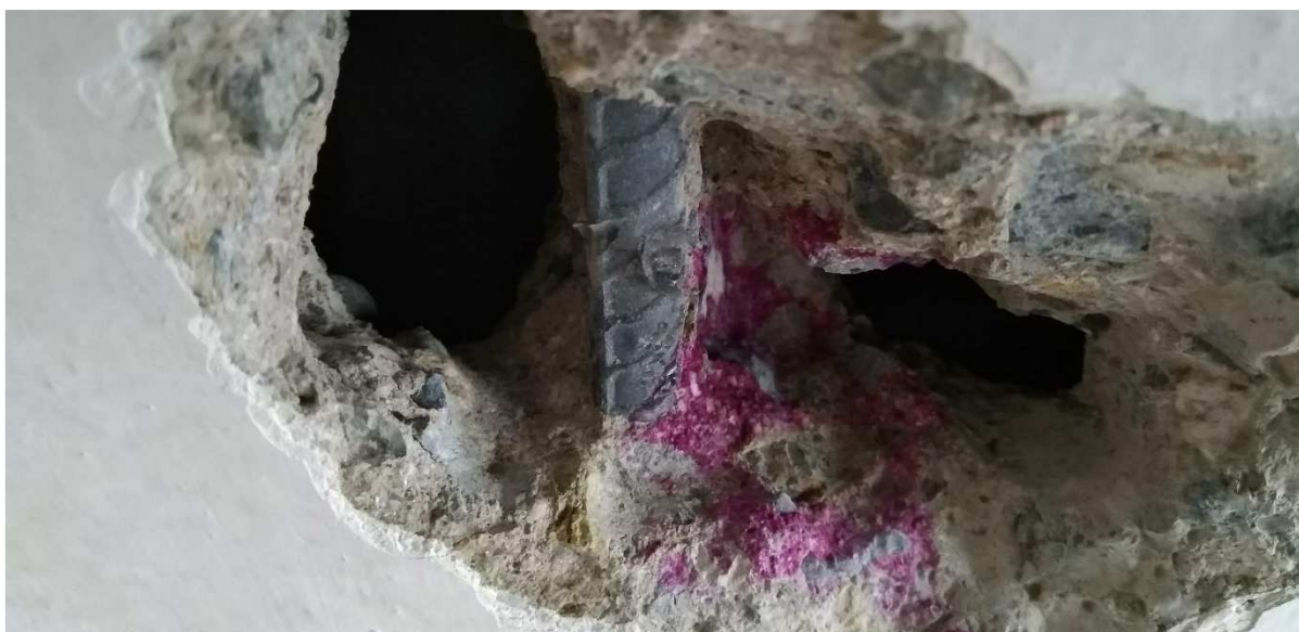
Obr. 6.3: Žebrování prutu \varnothing 10 s orientační zkouškou karbonatice (Krejčíkova, Plzeň)
