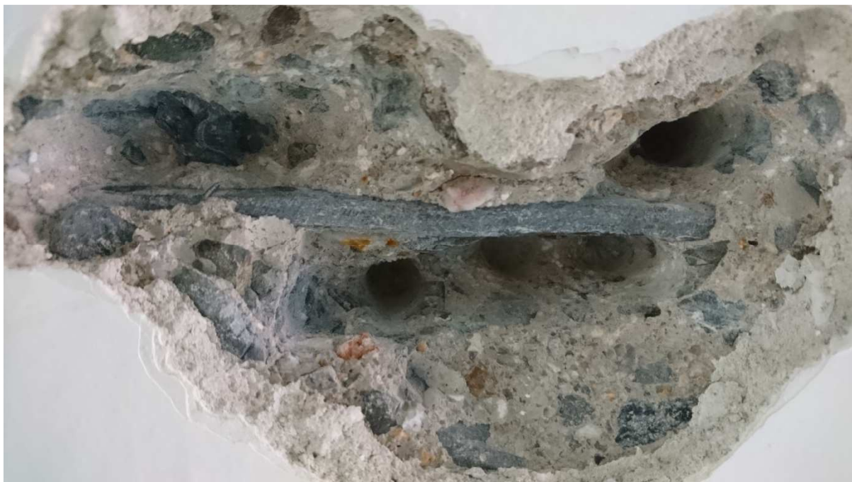
Obr.6.8: Obnažení prutu rozdělovací výztuže (Ke Špitálskému lesu, Plzeň)
