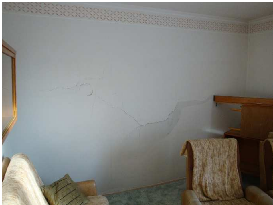
Obr. 2.2: Příklad havárie přičky, vlivem nadměrného dotvarování stěn a stropu Nepomucká 175/4, Plzeň – 03/2014
