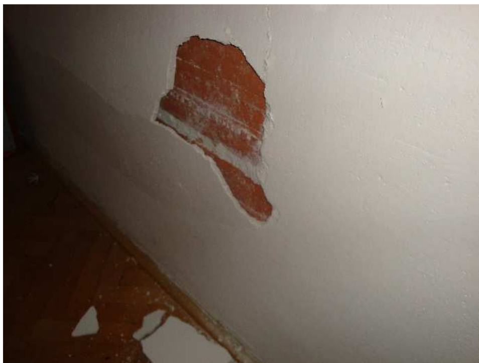
Obr. 2.3: Příklad havárie přičky, vlivem nadměrného dotvarování stěn a stropu Nepomucká 175/4, Plzeň – 03/2014
