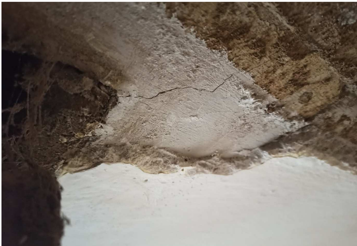
Obr. 6.12: Trhlina vycházející z rohu otvoru instalačního panelu
