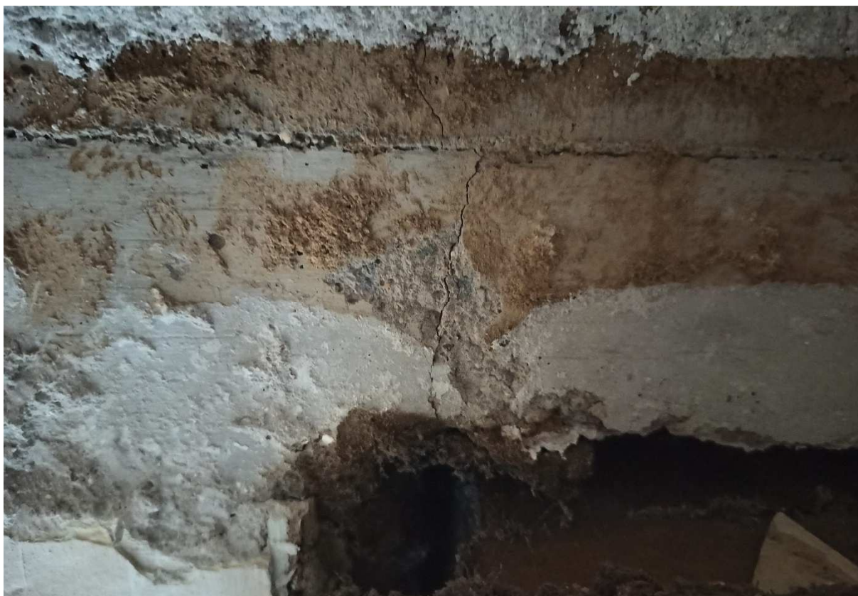
Obr. 6.13: Trhlina vycházející z otvoru instalačního panelu
