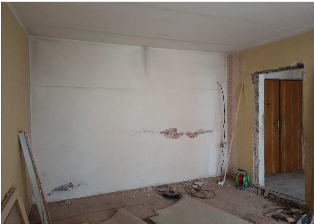
Obr. 2.4: Příklad havárie příčky, vlivem nadměrného dotvarování stěn a stropu Nepomucká 175/4, Plzeň – 01/2021
