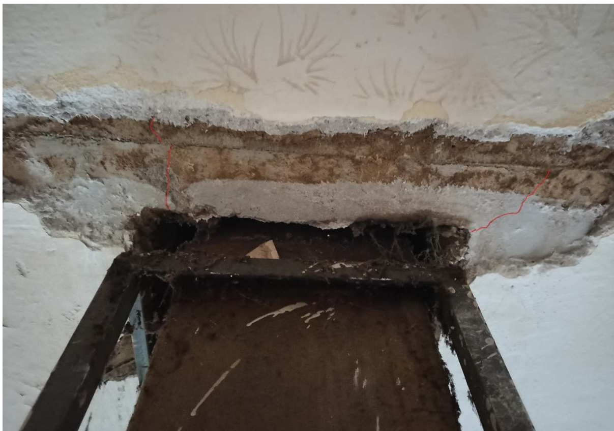
Obr. 6.11: Pohled trhliny v okolí otvoru po vybourání příčky
