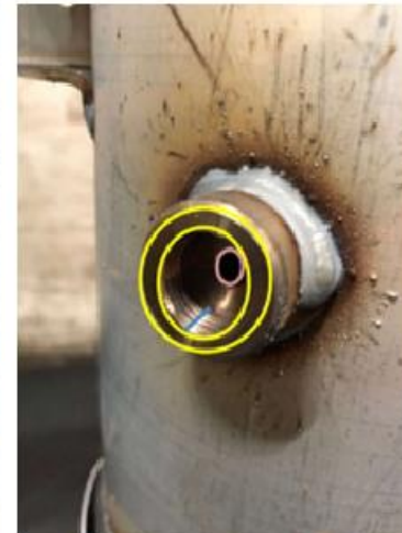
P6 - Upstream čidlo tlaku
