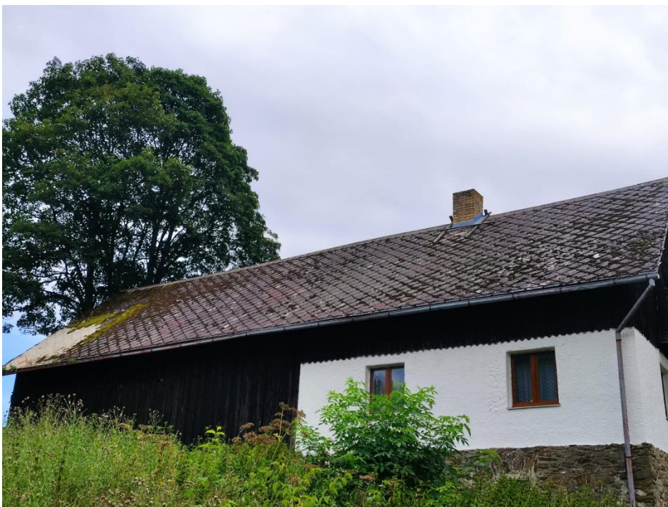
Příloha č. 4: Detail střechy, v níž jsou dodnes vidět známky střelby. 99
