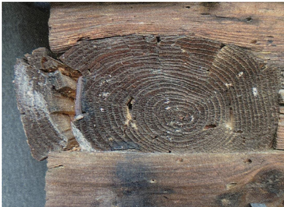
Obrázek 4.3 – Destrukce trámu vlivem tesařika krovového
