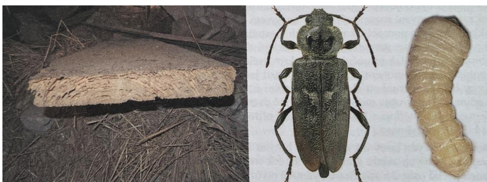
Obrázek 2.6 – Požerkové chodby a nepoškozená povrchová vrstva (vlevo) od tesaříka krovového Zdroj: (Drdácký, 2015)
