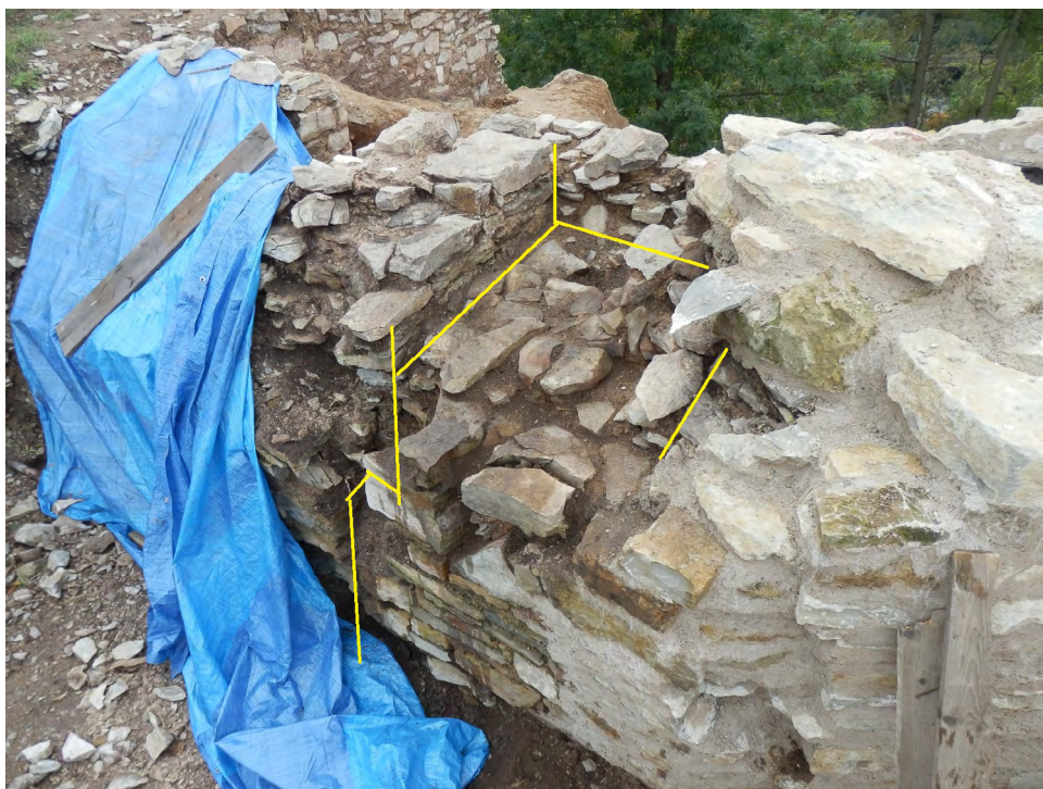
Obr. 13. Brandýs nad Orlicí – hrad. Zazděný dveřní otvor do místnosti 3 ve struktuře 901. Pohled k jihozápadu z prostoru snížené centrální části (foto J. Šmejdiř). – Fig. 13. Brandýs nad Orlicí – castle. Walled-up doorway to Room 3 in structure 901. View towards the south-west from the lowered central area (photo by J. Šmejdiř).
